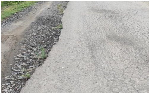
Gambar 1. Kerusakan retak kulit buaya Dan Amblas
